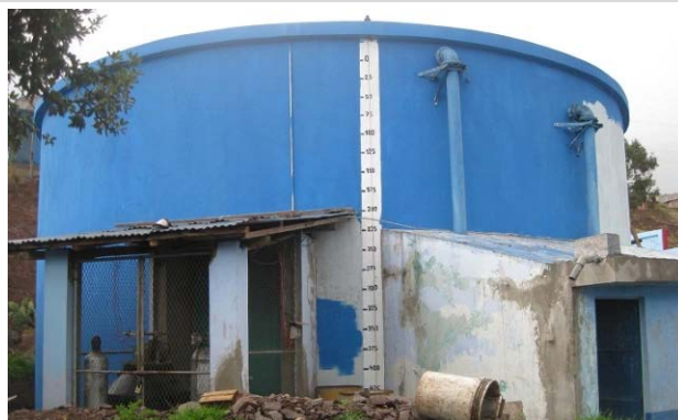
Reservorio de agua potable en la margen derecha del Huatanay. Imagen tomada de Sicuani Noticias.
